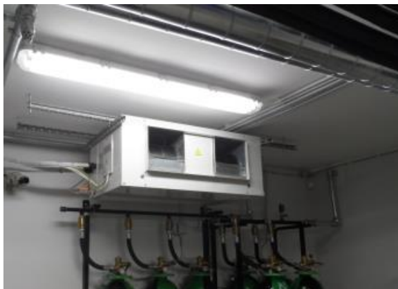
Joonis 4.25 UPS-i ruumi jahutusseade
