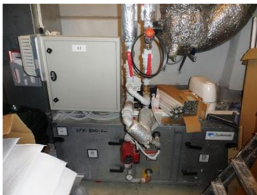
Joonis 4.18 Söökla ventilatsiooniagregaat
