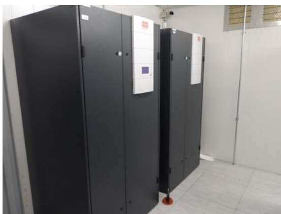
Joonis 4.24 Serveriruumi täppiskonditsioneerid
